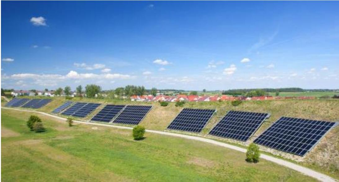
Abbildung 4-4 Freiflächen-Solarthermieanlage in Crailsheim (Quelle: (VDE VERLAG))
